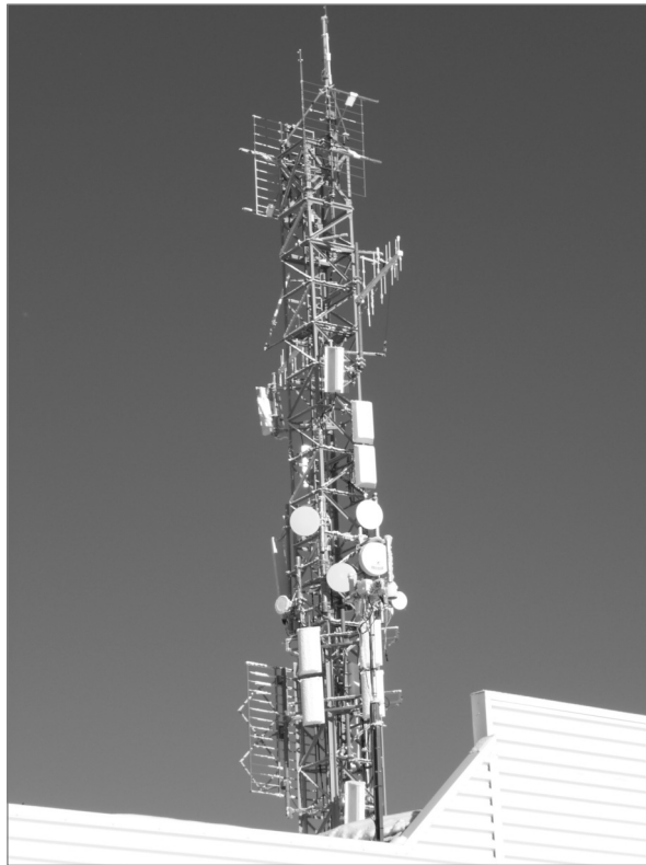
Rys. 7. Maszt antenowy systemu GSM-R wraz z instalacją odgromową
