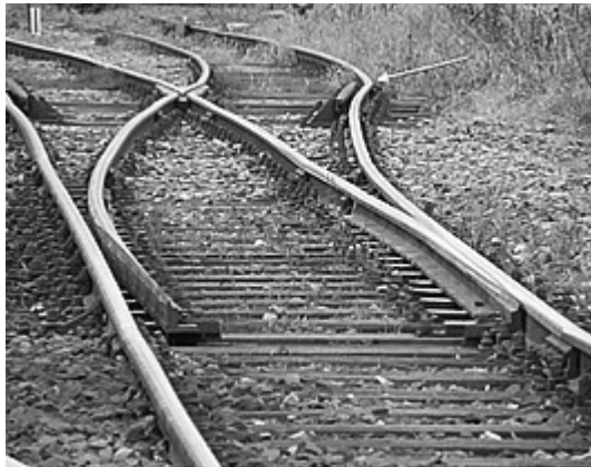
Rys. 1. Rozjazd S49 -300-1:9 prowadzący na tor boczny (w głębi widoczna wykolejnica) bez wstawki prostej za torem zwrotnym (fot. R. Piątek)
