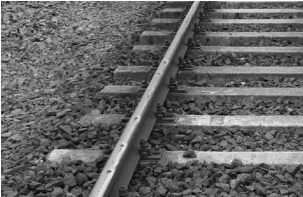
Rys. 9. Powierzchnia toczna szyny z licznymi wadami [fot. autor]
