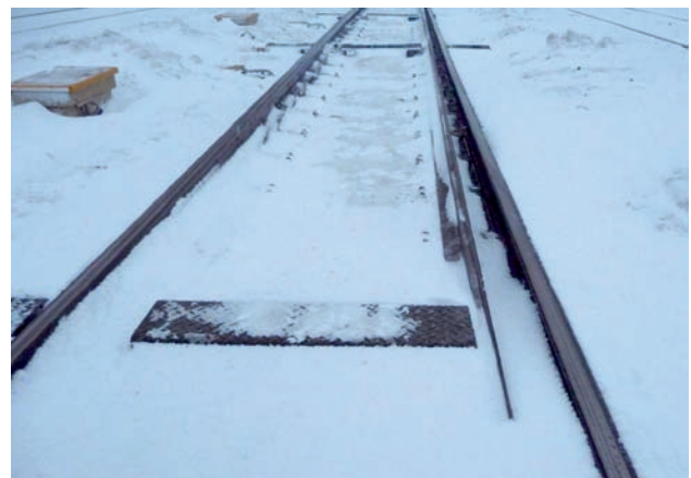
Rys. 3. Nieefektywne wytapianie śniegu przy ostrzu iglicy podczas intensywnych opadów śniegu; widoczna nierównomierność wytapiania się śniegu wzdłuż opornicy [PKP PLK S.A., styczeń 2011 r.]
