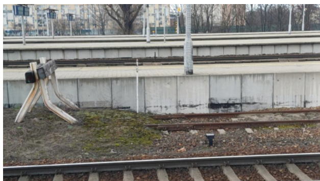
Rys. 7. Przykładowa konstrukcja urządzenia zakończenia torów na stacji Warszawa Wschodnia [fot. W. Kowalczyk]
