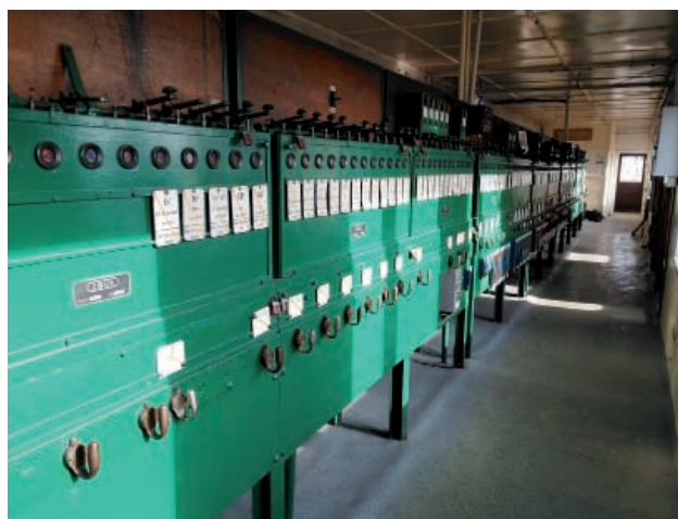
Rys. 9. Dotychczasowe urządzenia mechaniczne w starej nastawni na stacji Białystok (5.10.2023 r.) [fot. T. Lotowski / PLK]
